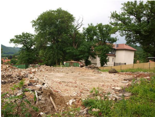
Bodenplatte und Trümmer des (Blick Richtung Südwesten)
